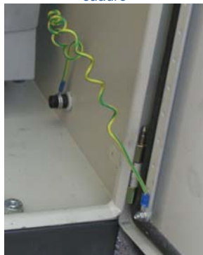
Detalle toma de tierra en cuadro
