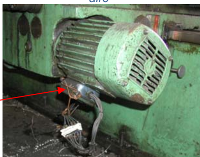
Empalme incorrecto y al aire
